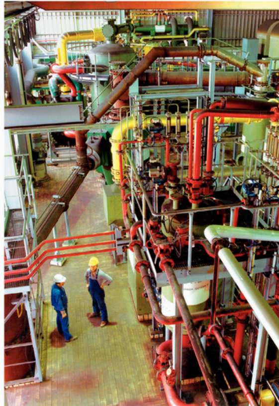
Blick in die Anlage zur TiO 2 -Herstellung nach dem Chlorid-Prozess im Werk Leverkusen von Kronos Titan.
